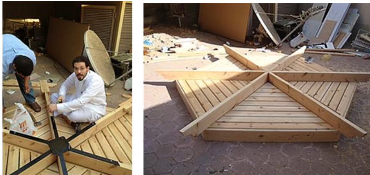
(شكل 25) يوضح تجهيز وتجميع وحدة السقف للمظلة السداسية وقد تم إبتكار وحدة تجميع معدنية لتكون مثبتة من الجهتين "أعلى وأسفل عوارض السقف
