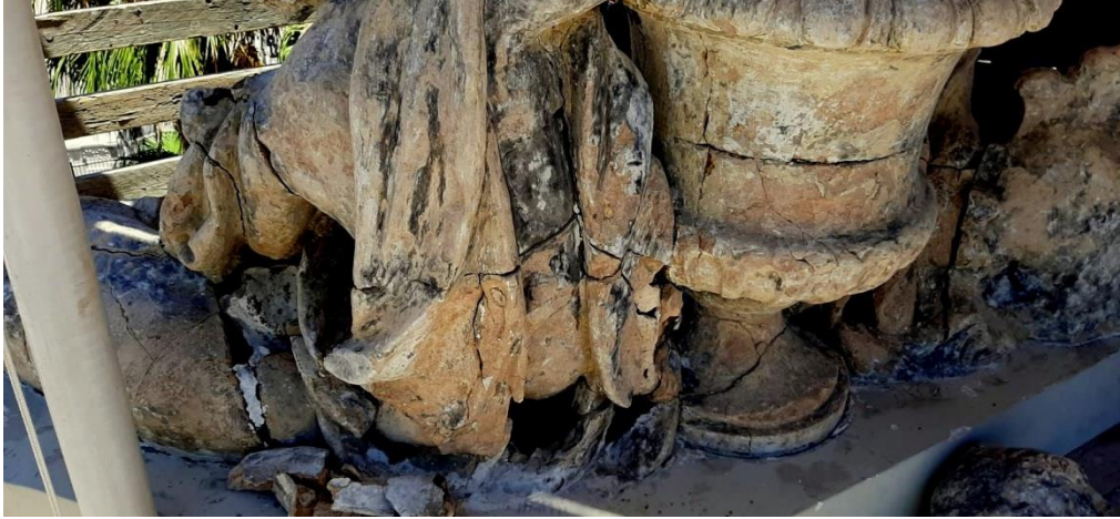
شكل رقم (١١): من مظاهر الاجهادات الميكانيكية و الانشائية في جسم التماثيل اسم العمل: تماثيل الاطفال الملائكة
