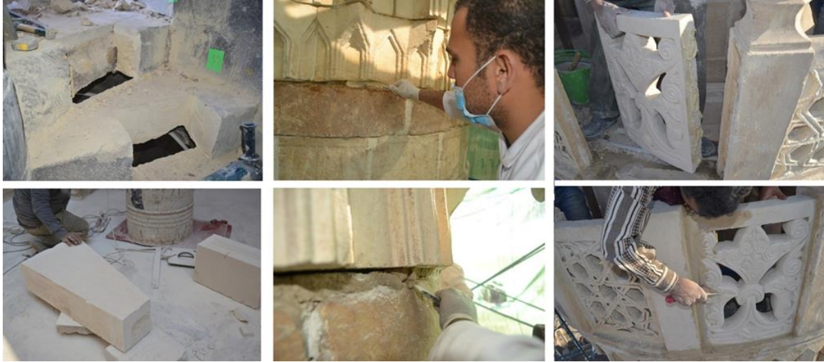
شكل (٢١) ترميم درج السلم التالف واستكمال المفقود بعمل درج جديد مثيلة للقديمة وتثبيتها بالايبوكسي
