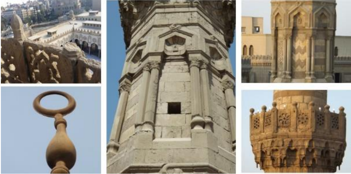
شكل (١٥) يوضح المآذنة قبل الترميم
