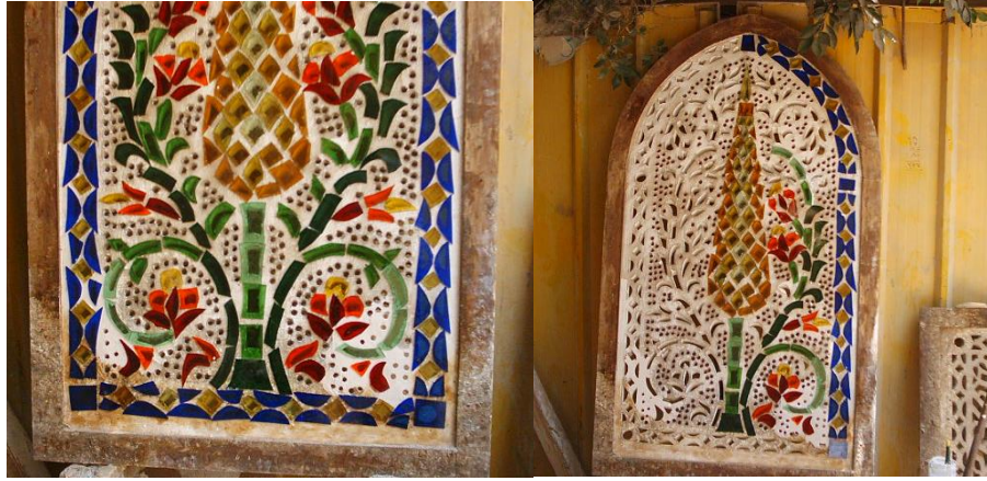
شكل ( ١٣ ) يوضح الشباك معشق من الجص مستوحى من شجرة السرو قبل واثناء الترميم
