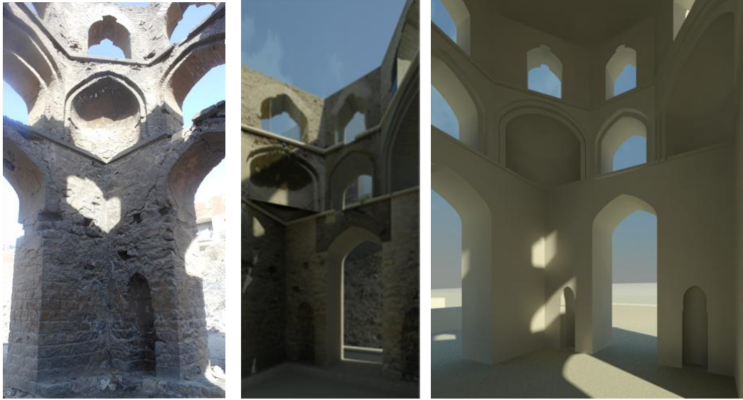
الرسم (٨): لقطة منظورية داخلية للضريح الثاني علي اليمين، ولقطة للوضع الحالي في المنتصف، وصورة للمبني حاليًا علي اليسار (عن الباحثة)
