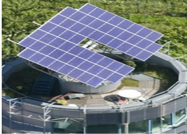
صورة رقم (١٧) توضح الخلايا الشمسية على سطح المبنى تتحرك مع حركة الشمس للإستفادة بأكبر قدر ممكن من الطاقة الضوئية
